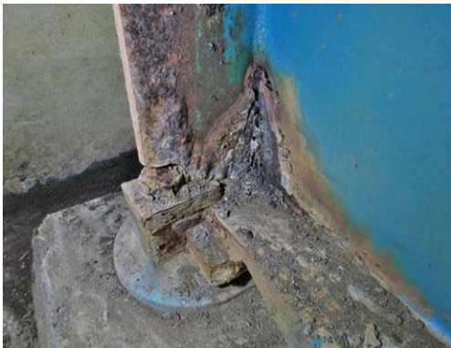
写真3-3 主桁端部の腐食
