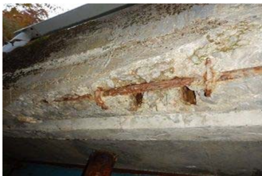
写真4-14 【損傷】地覆の断面欠損
