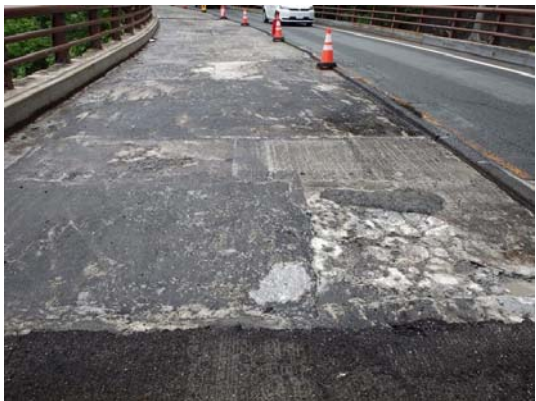
写真4-2 【損傷】床版ひびわれ、遊離石灰
