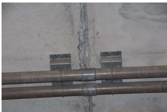
写真4-17 【損傷】覆工のうき、剥落
