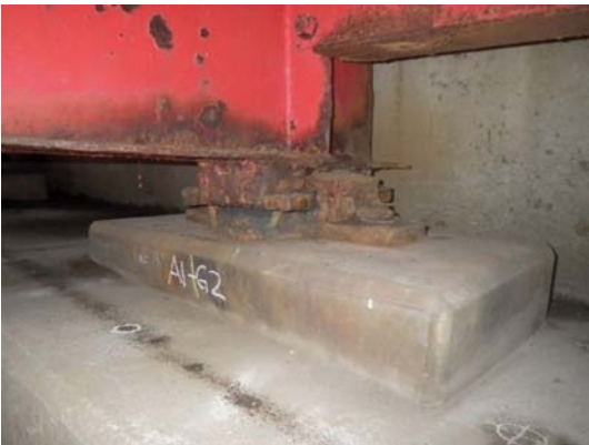
写真4-8 【損傷】主桁、支承の腐食 防食機能の劣化
