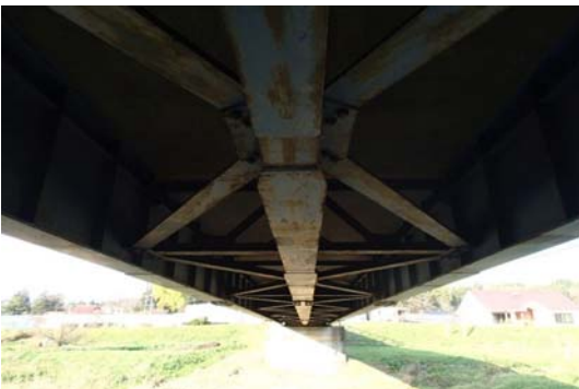
写真4-11 【損傷】 主桁の腐食、防食機能の劣化
