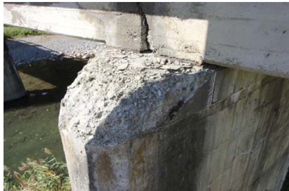
写真3-4 橋脚梁部コンクリートの剥離
