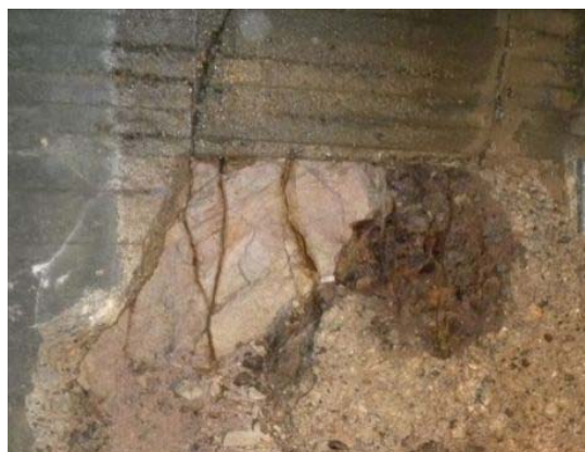
写真4-20 【損傷】覆工の剥落
