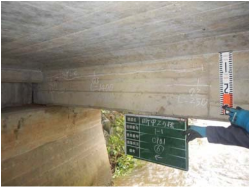
写真4-5 【損傷】主桁のひびわれ
